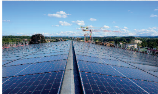
Archivbild (oben): Das Unternehmensgebäude in den 1970er Jahren. Im September 2022 wurden auf dem Dach der Model AG in Weinfelden Solarpanels montiert.
