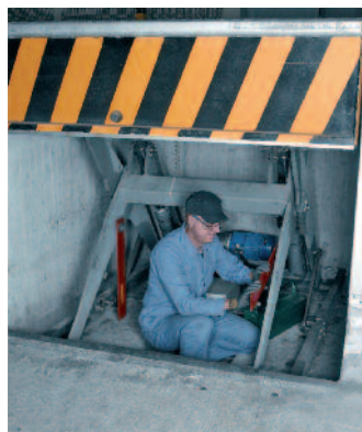
Wo gefährliche Energien vorhanden sind (ungesicherte oder angehobene Lasten), muss dafür gesorgt werden, dass keine Gefahr besteht.
