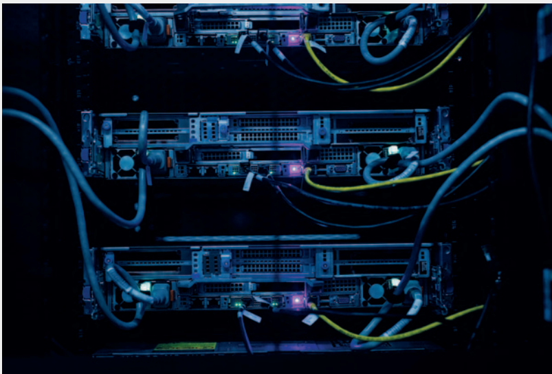
Bis zu 100.000 KI-Spezialchips sollen künftig im Rechenzentrum installiert werden. Im Vergleich dazu soll das Rechenzentrum, das die Telekom und Nvidia derzeit in München bauen, mit 10.000 GPUs laufen. Das Schwarz Digits Datacenter leistet somit einen Beitrag zur digitalen Souveränität.
