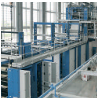
Die erste Sektion der Cortina-Anlage bei De Persgroep, auf der täglich De Morgen gedruckt wird. Das Unterbauelement, auf das der Heißlufttrockner installiert wird, ist bereits vorhanden.
