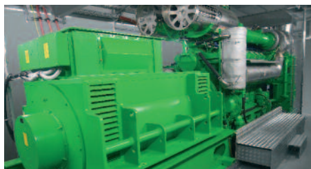
Das Blockheizkraftwerk deckt den Jahres-Durchschnitts-Strombedarf von Sihl. Die 2012 instal-
