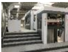
Seit Anfang Februar 2018 ist das neue Stanzsystem vollständig in die laufende Produktion eingebunden.
