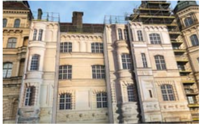
Während der Renovierung von Schloss Güstrow verdeckten großformatige Planen die Bauarbeiten. Die Besucher sahen zwar nur die bedruckten Banner, erhielten aber gerade deshalb eine gute Vorstellung davon, wie es später aussehen wird. (Bildquelle: HP.)
