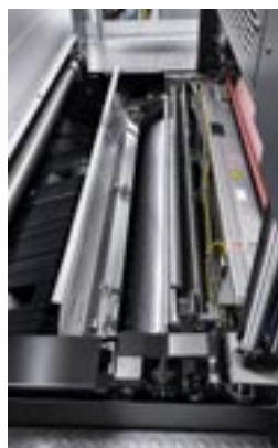
Die wassergekühlte LED-Lösung LEDcure NX wurde auf einer Heidelberg XL 106 für End- und Zwischentrocknung installiert.
