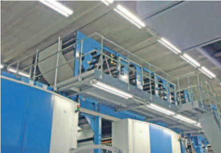
Passt genau: Gerade einmal 40 Zentimeter Platz sind noch zwischen dem Überbau der Commander CT und der Hallendecke.
