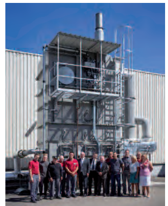
Medienunternehmer Heinz Wurzel und die Mitarbeiter freuen sich über die neue Nachverbrennungsanlage.
